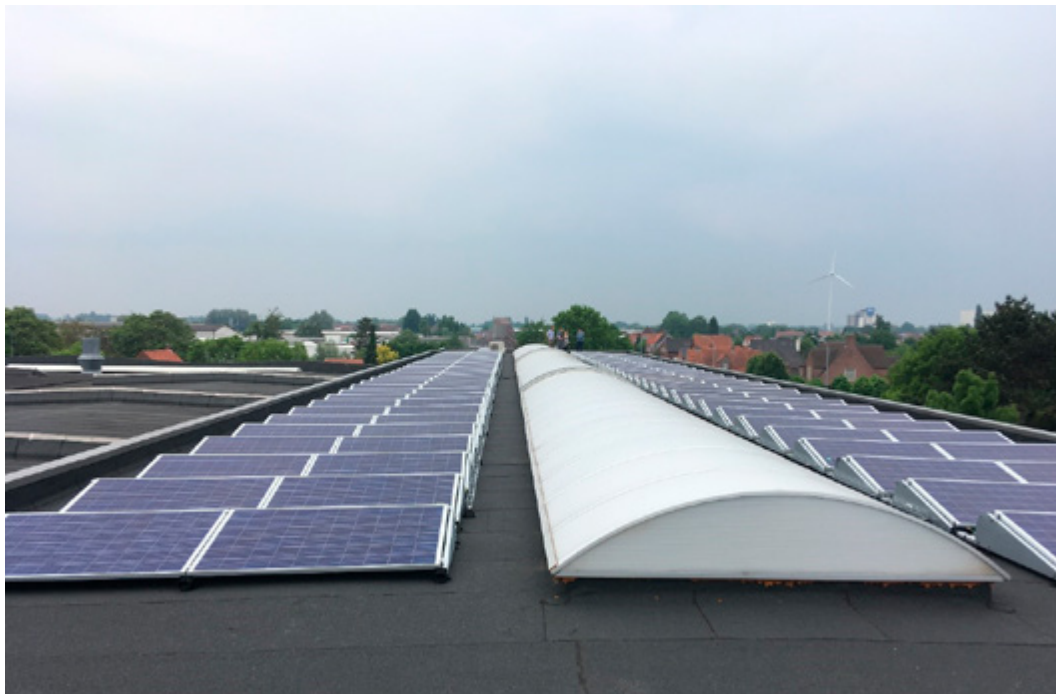
Bedrijven ontzorgen bij het investeren in zonnepanelen is één van de doelstellingen van het project BISEPS. Bij Handsaeme Machinery in Izegem werd alvast een eerste installatie zonnepanelen gebouwd.
